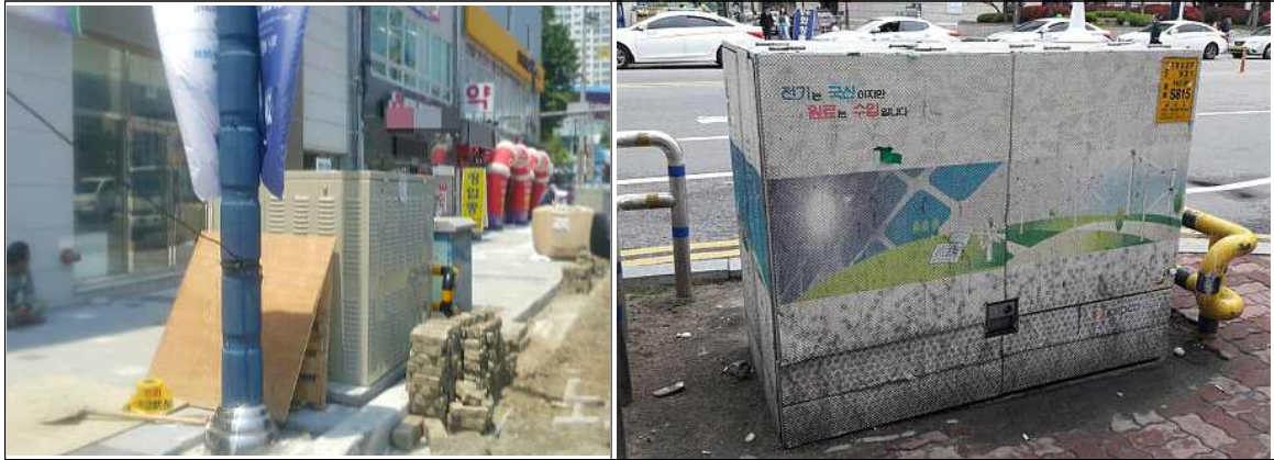
[그림 2] 지중화사업 후 지상변압기 설치 사례
